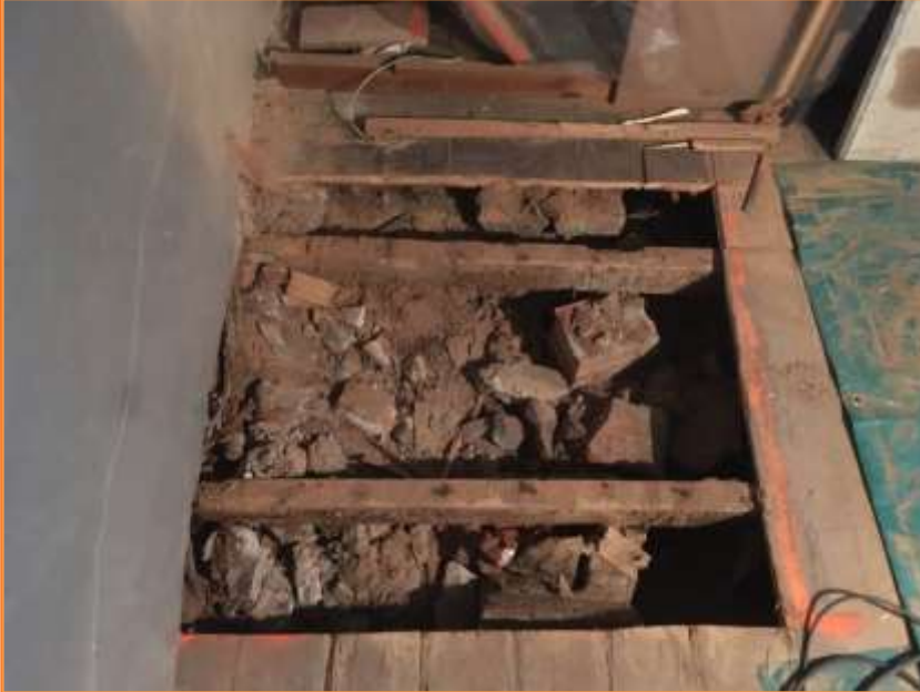
Foto 11. Vista de la cala núm. 3 un cop extret el paviment UE 30, inici del nivell UE 33.
